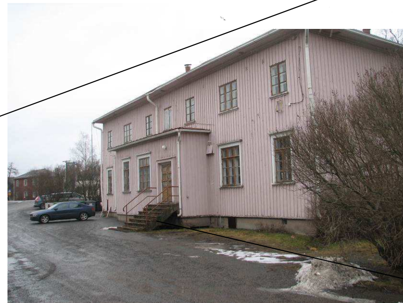
Kuva 46. Julkisivu pihan puolella. Pääporras on pakkasvaurioitunut.
