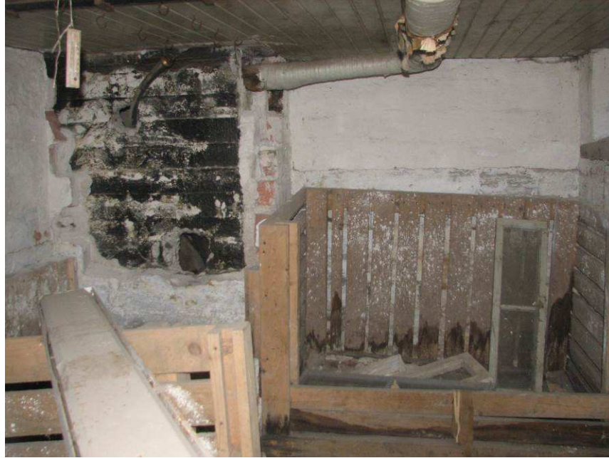
Kuva 1. Näkymä kellarista. Kellari on kostea ja siellä vallitsee pistävä kellarimainen haju. Puurakenteet kellarilattiaa vasten ovat lahovaurioituneet. Kellariseinien alaosissa esiintyy kosteusjälkiä.
