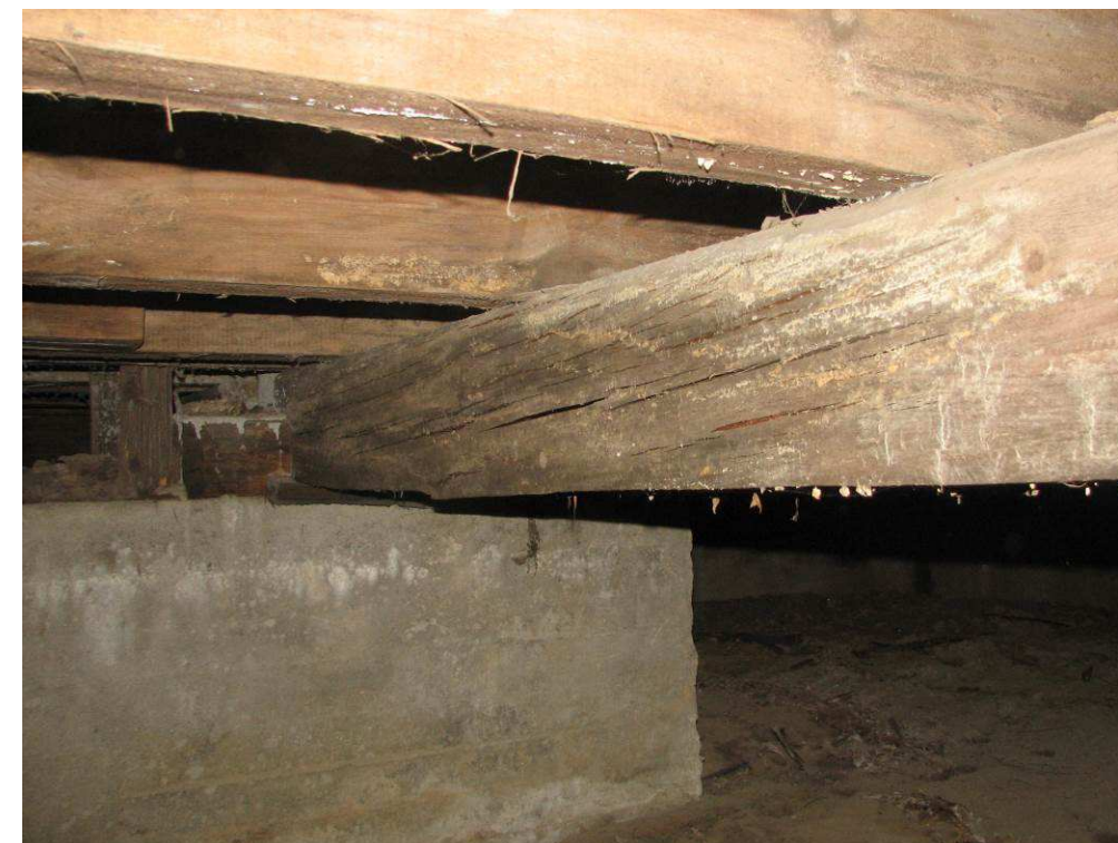
Kuva 7. Palkin lahoamisaste on pitkälle edennyt ja on lähellä murtumisastetta. Kuvan kohta on keskellä taloa. Ryömintätilassa on pistävää mullan/maakellarin hajua.
