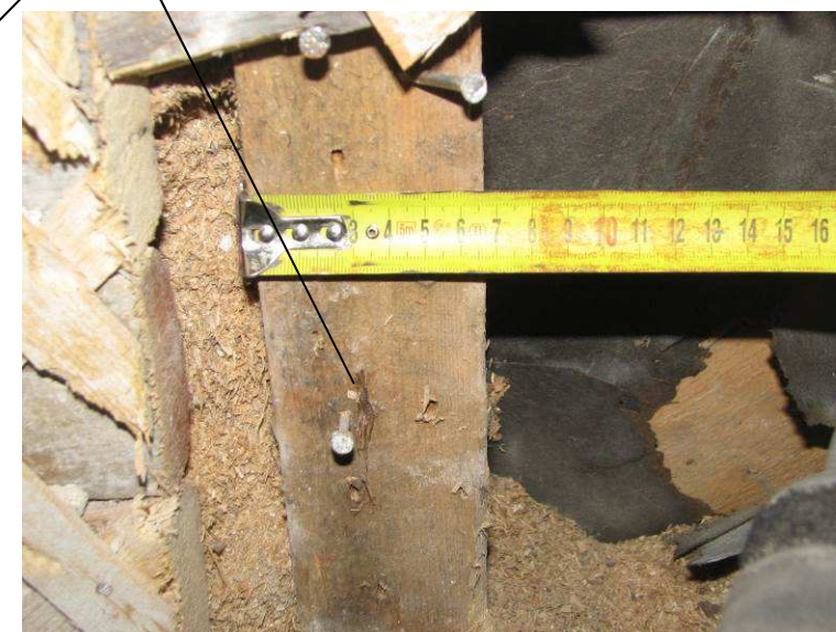
Ulkoseinän runkotolppa näkyvästi mikrobivaurioitunut.
