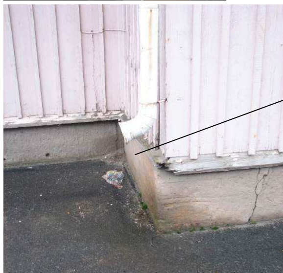
Sadevesi syöksytorstista tuleva sadevesi rasittaa sokkeliä ja ryömintätillaa talon ympärillä. Sokkelin halkeamien kautta vesi valuu ryömintätilaan.
