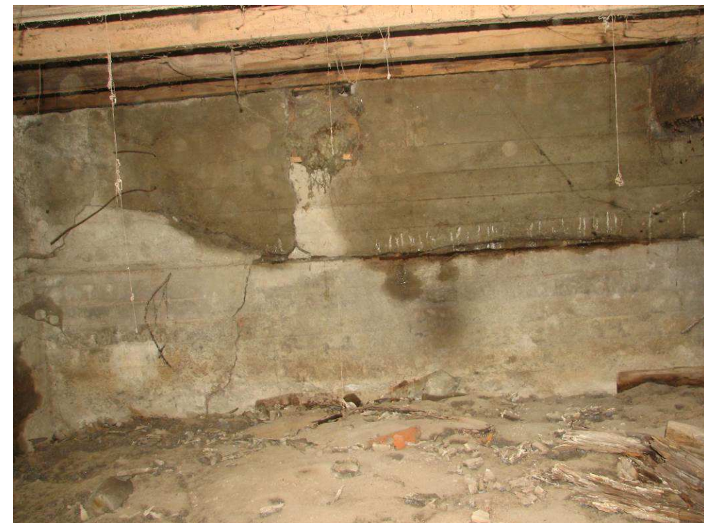
Kuva 16. Sokkeli on kylmä talven seurauksesta, ryömintätilan maakosteus tiivistyy sokkelin pintaan ja esiintyy kastuneena sokkelina ryömintätilan puolella.
