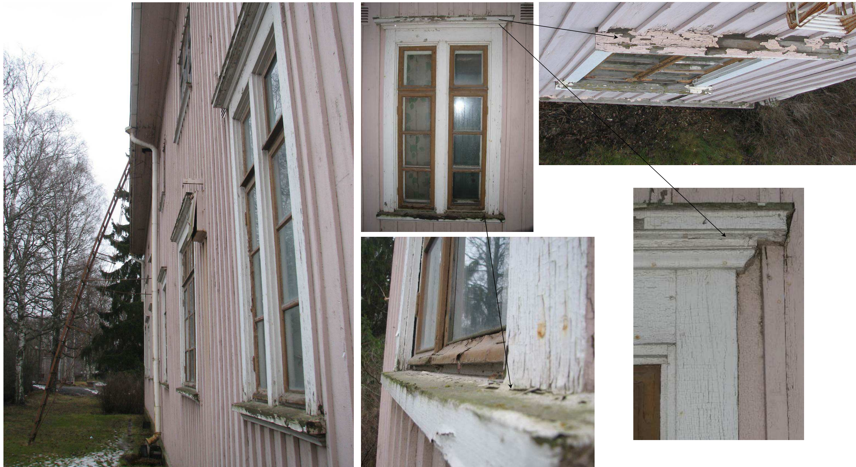
Kuva 50. Ikkunat yleensä. Ikkunapeltjä ei ole vaan ne on toteutettu puulaudasta joka on kosteusriski ulkoseinärakenteelle ikkunan alla ja ikkunan päällä kuten kuvissa esiintyy.
