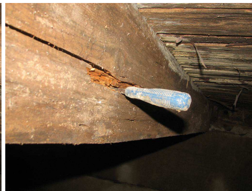
Kuva 10. Lähikuva palkkien lahoasteesta. Palkin ulkopinta on kovempi ja palkki kuulostaa ontolta kun sen päälle koputtaa. Palkkiin voi helposti työntää taltan kuten kuvasta näkyy. Palkin kantokyky on alentunut.
