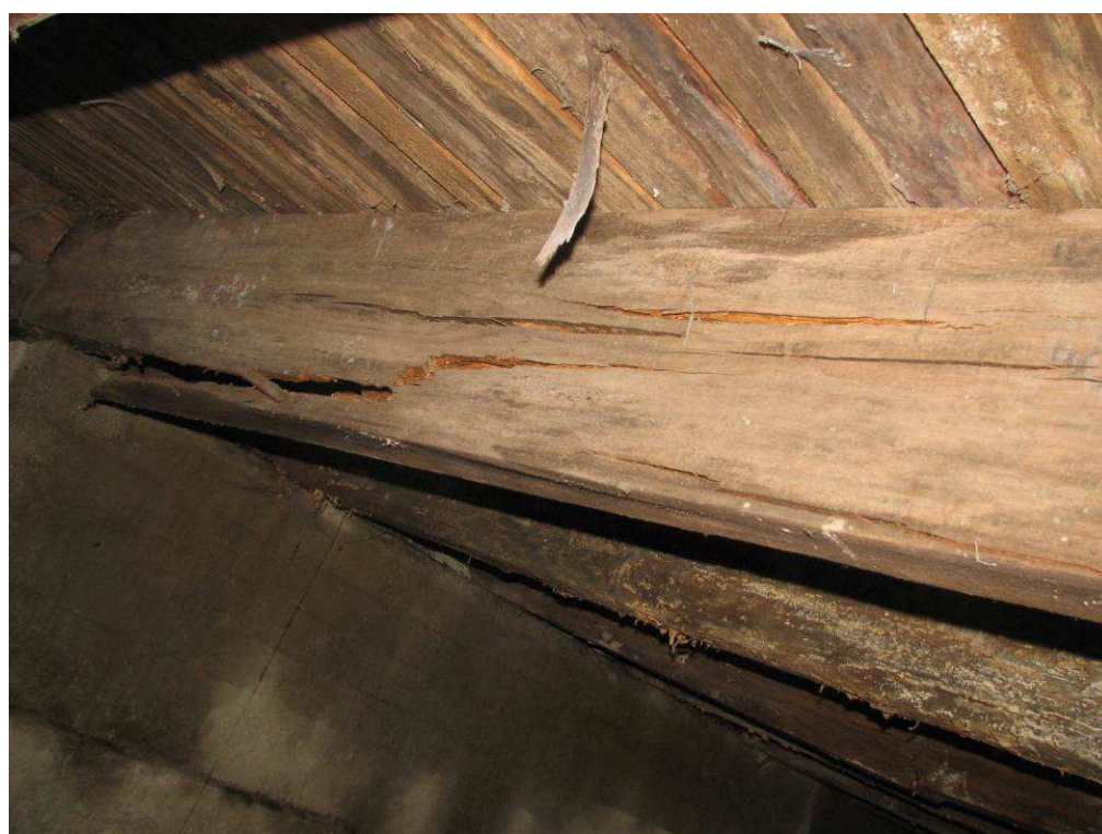
Kuva 8. Kantava lattiapalkki on murtunut lahovauriosta johtuen.
