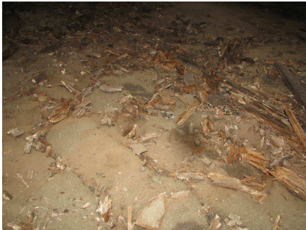
Kuva 14. Ryömintätilan maanpinta on saviperäistä maata, savirakeita. Sen pinnalla esiintyy puujätteitä.
