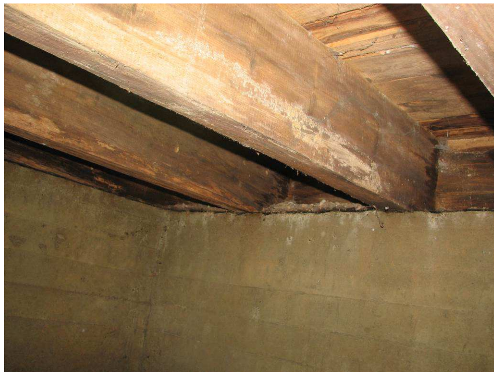
Kuva 6. Yleisnäkymä lattiapalkkien kunnosta ryömintätilassa. Ulkoseinien/sokkelin kohdalla palkeissa on tyypillisiä kosteusvaurioita jotka ovat edenneet lahovaurioasteeseen.
