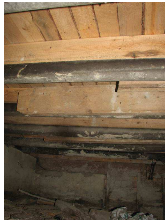
Kuva 15. Alapohjarakenne on aikoinaan uusittu kuten kuvasta näkyy. Alue joka on uusittu on rajattu ja on TV-huoneen / kokoussalin alla.
