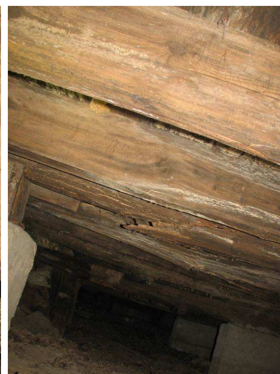
Kuva 9. Kuva otettu keskeltä taloa kellaritilojen läheltä. Lattiapalkit ovat murtuneet/katkenneet lahon seurauksesta.
